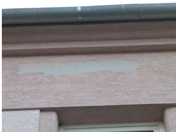
Obr.38 Opadávání omítkové povrch. úpravy z důvodu nepřijatelně nízké teploty podkladu při provádění
