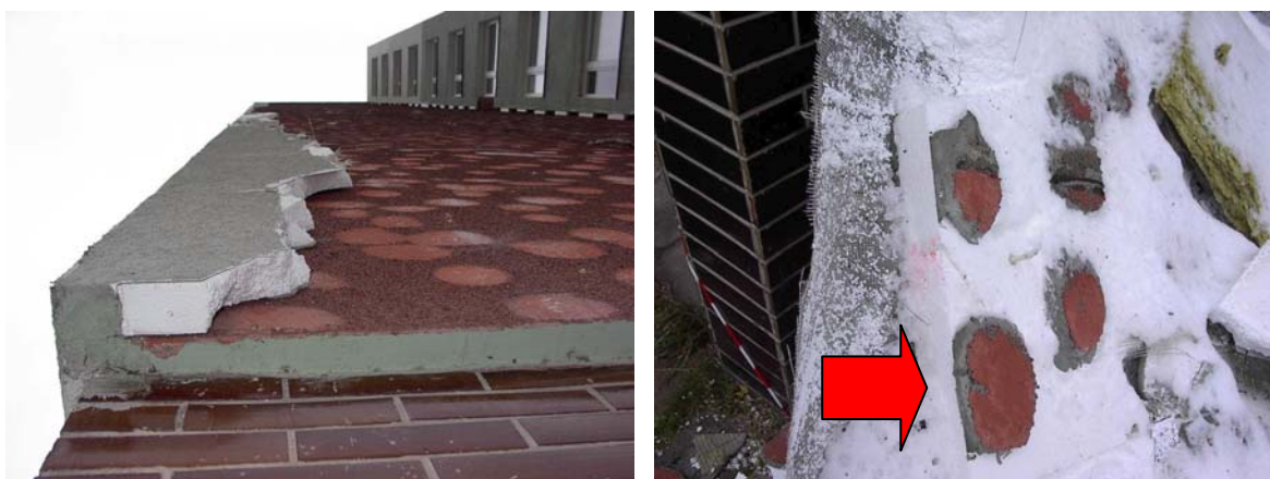
Obr.4 a 5 Nnezajištění požadované soudržnosti lepicí hmoty s podkladem a zásadně nesprávný způsob jejího nanesení na desku tepelné izolace
