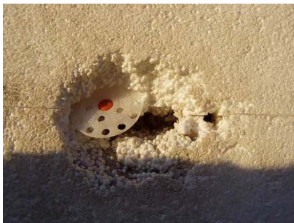
Obr.27 Výrazně špatně osazená hmoždinka (z fotoarchivu firmy STOMIX s.r.o.)
