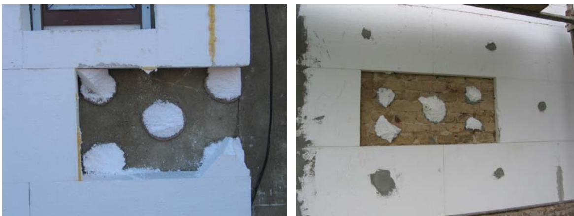
Obr.8 a 9 Zásadně nesprávný způsob nalepení desek z EPS z hlediska správného umístění lepicí hmoty a velikosti lepené plochy
