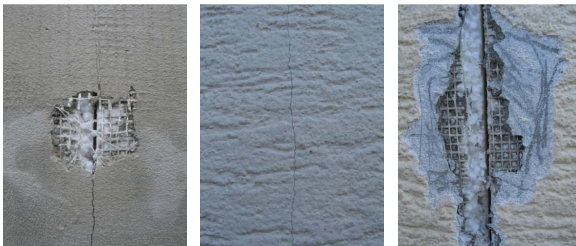
Obr.28 Vznik trhlin v místech nepřeložených síťovin jak v základní vrstvě, tak ve vrstvě konečné omítkové úpravy. Místo nepřeložených síťovin bylo v obou dvou případech ještě navíc situováno do styků tepelně izolačních desek
