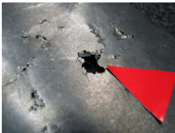
Obr.23 Detailní pohled na oplechování parapetu z TiZN zcela poškozeného elektrochemickou korozí (oplechování bylo připevněno lepicím tmelem)
