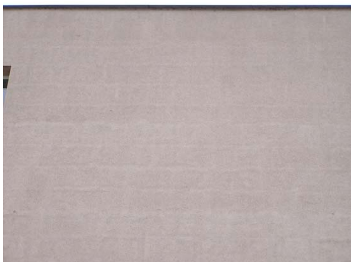
Obr.44 Viditelná kresba deformací tepelně izolačních desek z EPS v důsledku jejich špatného lepení (z fotoarchivu firmy Paulín CZ s.r.o.)
