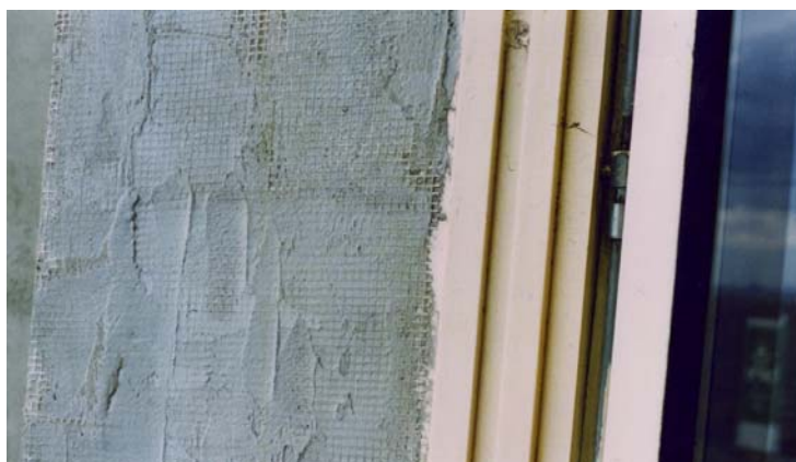
Obr.29 Nedostatečné krytí síťoviny a nepřípustně nerovný povrch základní vrstvy
