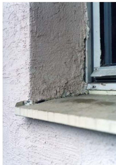
Obr.39 a 40 Nevyhovující způsob napojení zateplení a oplechování v místě okenního parapetu a to jak vzhledově tak funkčně
