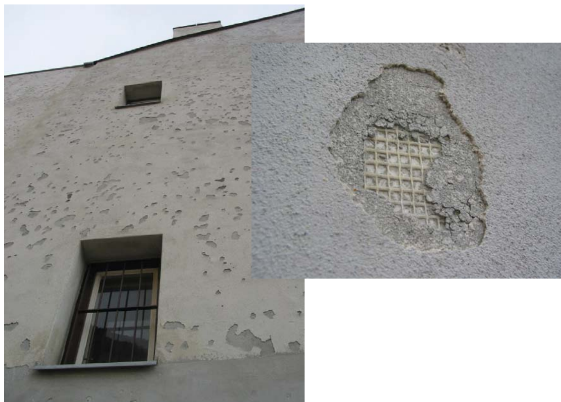
Obr. 3 Kontaktní zateplení provedené v tzv. „skládané“ (necertifikované) skladbě po krupobití
