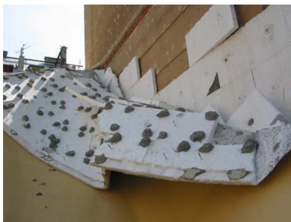
Obr.10 Zásadně nesprávný způsob nalepení desek z EPS z hlediska správného umístění lepicí hmoty a velikosti lepené plochy
