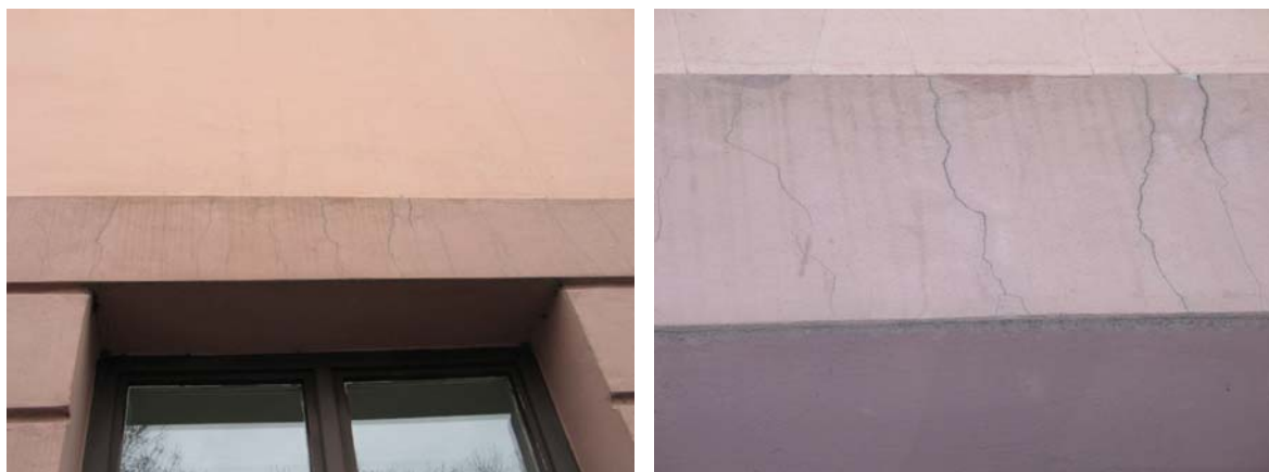
Obr.41 a 42 Použití nevhovujícího typu omítkové povrchové úpravy pro vnější kontaktní zateplovací systém – vpravo detailní foto
