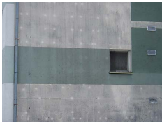
Obr.45 Viditelná poloha hmoždinek a některých styků desek z titulu rozdílných teplotních a vlhkostních toků, kdy tato místa na fasádách zůstávají ve světlejších odstínech (z fotoarchivu firmy STOMIX s.r.o.)
