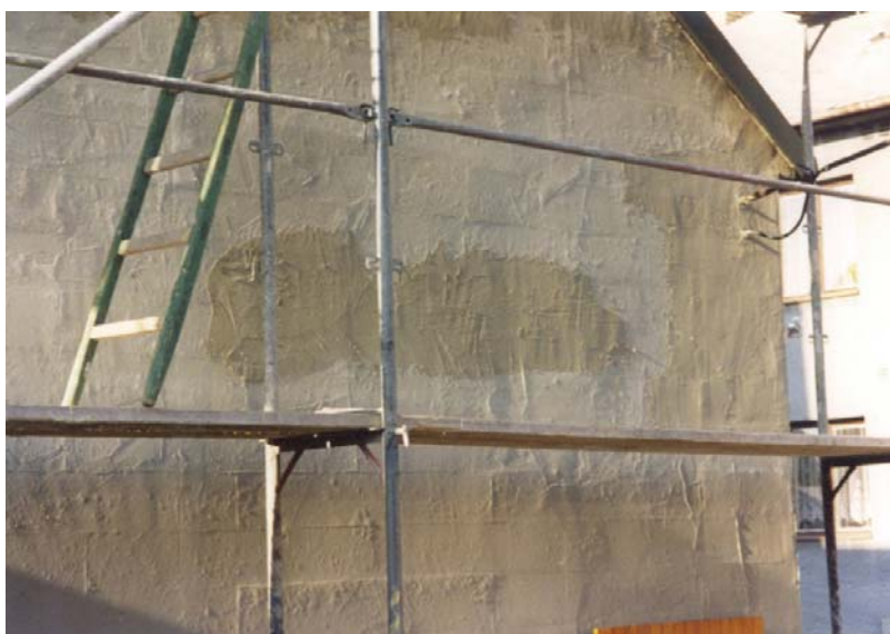
Obr.30 Nepřípustně nerovinná základní vrstva
