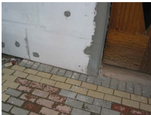
Obr.22 Nesprávná aplikace desek fasádního EPS v těsné blízkosti terénu
