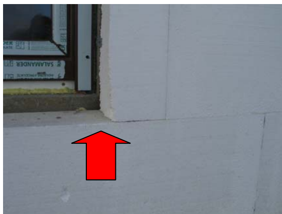
Obr.14 Nesprávný způsob osazení desky EPS z hlediska umístění jejího styku vzhledem k rohu stavebního otvoru
