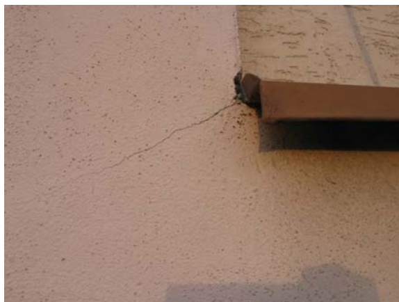
Obr.31 Vznik trhlin v dolním rohu stavebního otvoru
