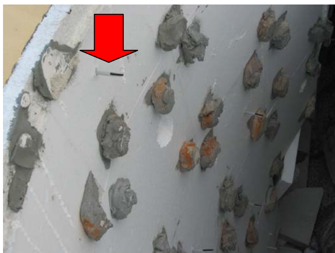
Obr.24 Detailní záběr havarovaného zateplení, kde hlavní příčiny byly v neošetřeném podkladu a v nesprávném lepení a kotvení, u kterého se to týkalo typu, počtu a rozmístění hmoždinek
