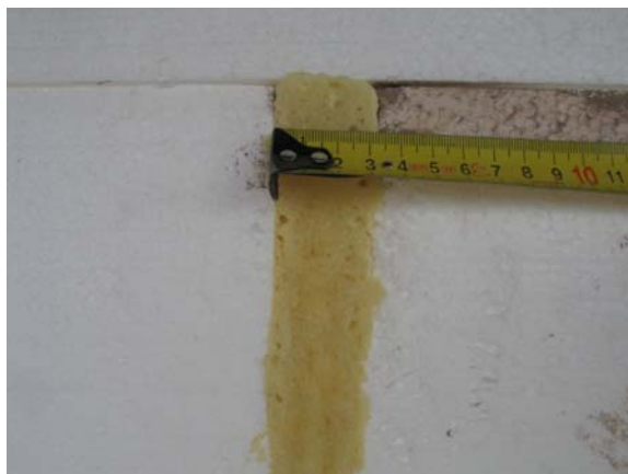
Obr.13 Nepřípustné vyplňování nadměrných spár pěnovou hmotou
