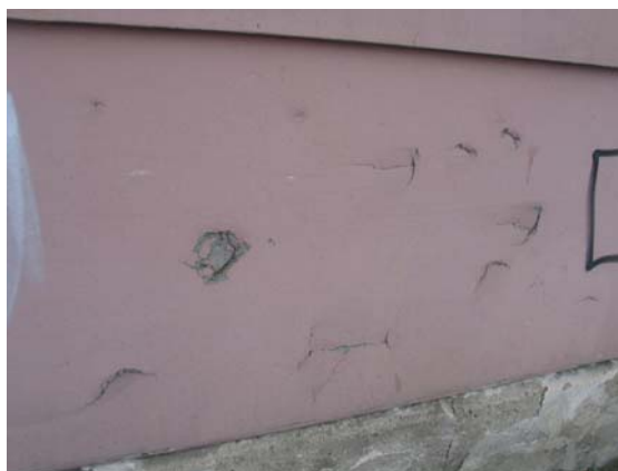
Obr.32 Mechanicky poškozené kontaktní zateplení provedené bez zesilujícího vyztužení
